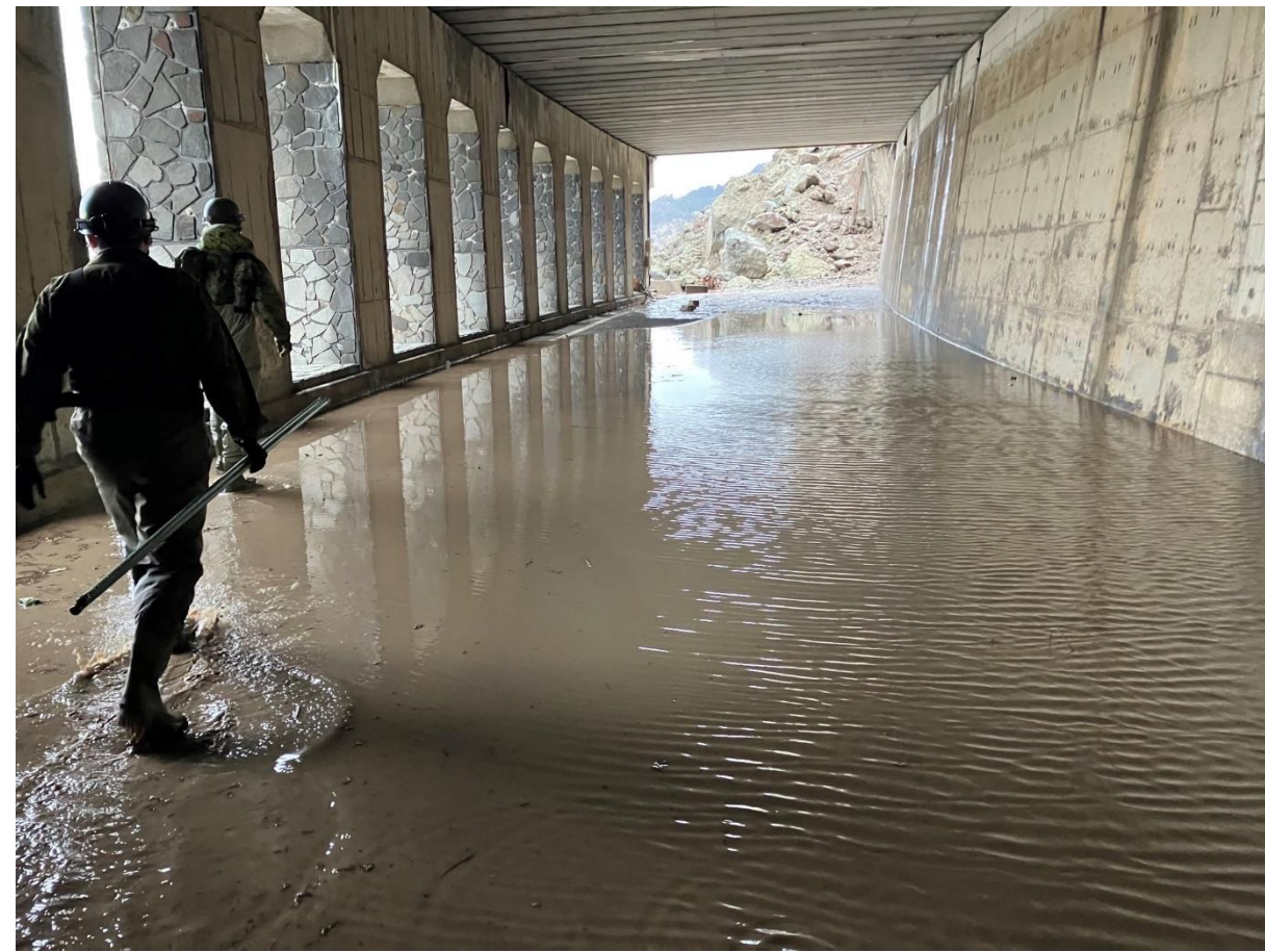
珠洲市 八世乃洞門新トンネル及び旧トンネルの状況・偵察
