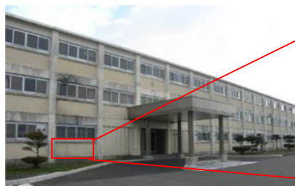
耐震性が不足する隊庁舎の建替
