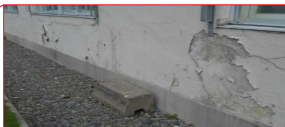
外壁のクラック
