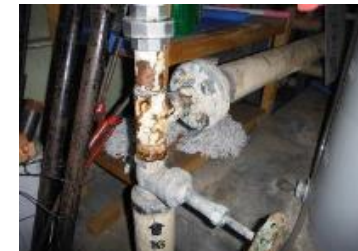
内部配管の腐食
