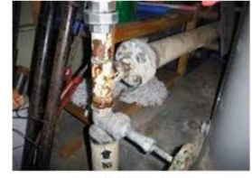
内部配管の腐食
